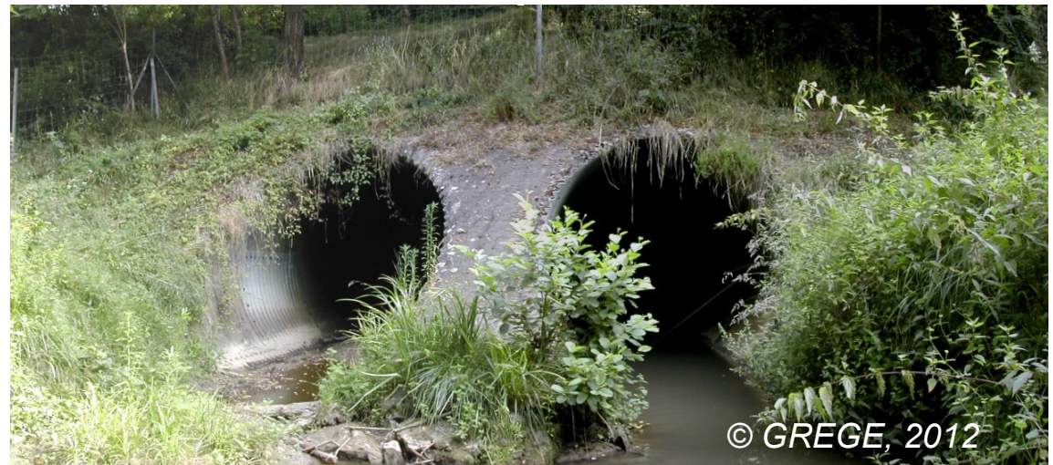
Ouvrage du Lisos à risque maximal
