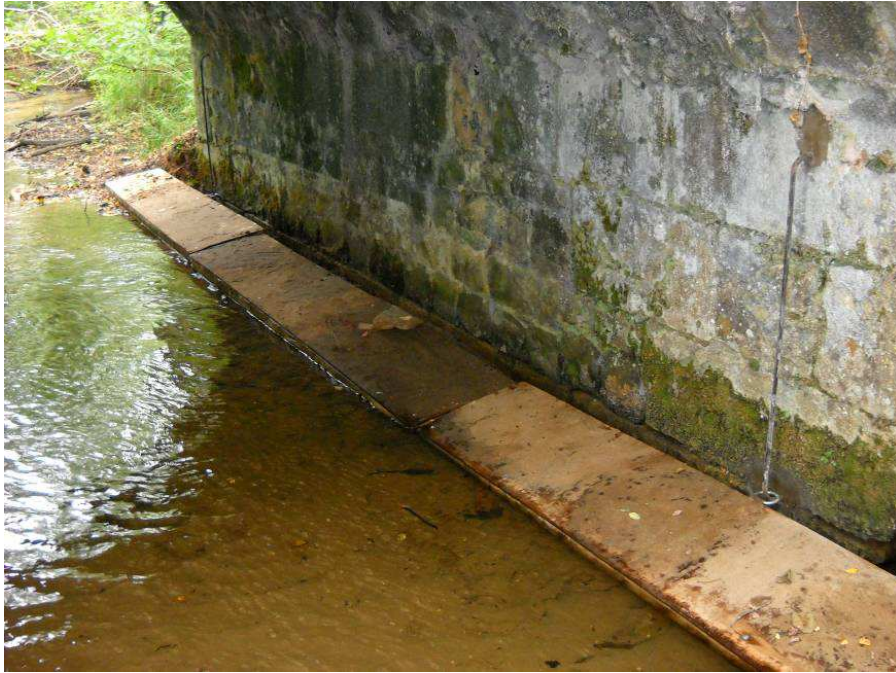
Ouvrage hydraulique du ruisseau du Ballion équipé d'un ponton GREGE (Photo : Pascal Fournier)
