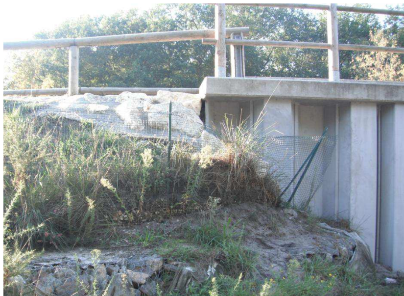
Exemple de dégradation constaté sur un ouvrage réhabilité en Gironde
