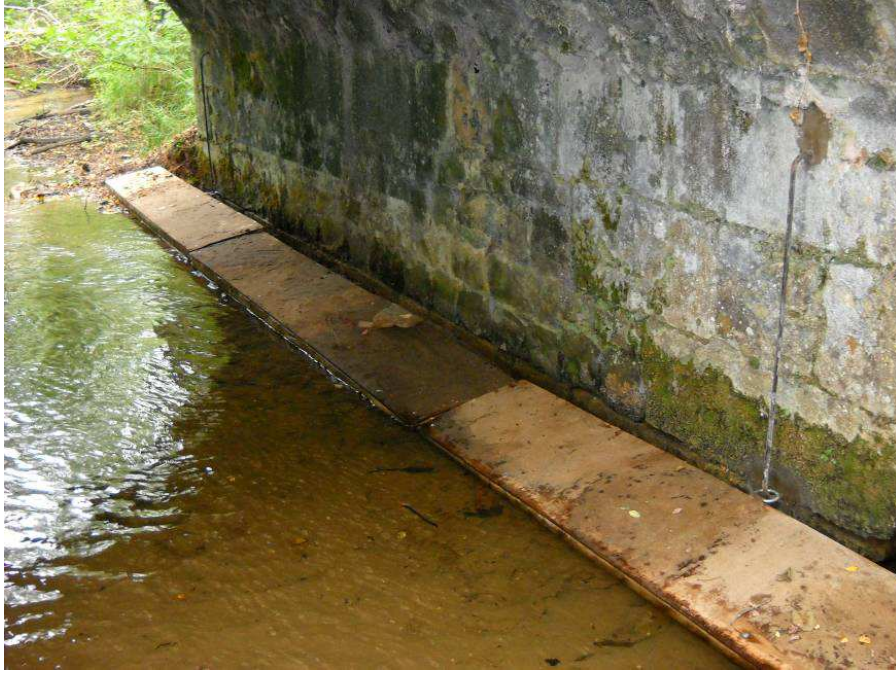
Ouvrage hydraulique du ruisseau du Ballion équipé d'un ponton GREGE (Photo : Pascal Fournier)
